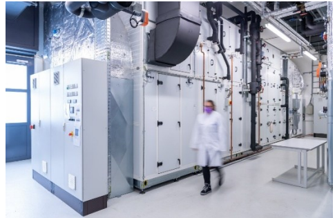
Trockenraum aus der Batterieproduktion (Uni Münster)
